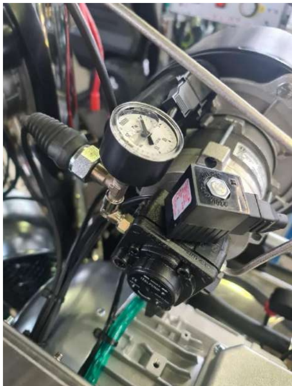
Manómetro de la bomba de gasóleo
