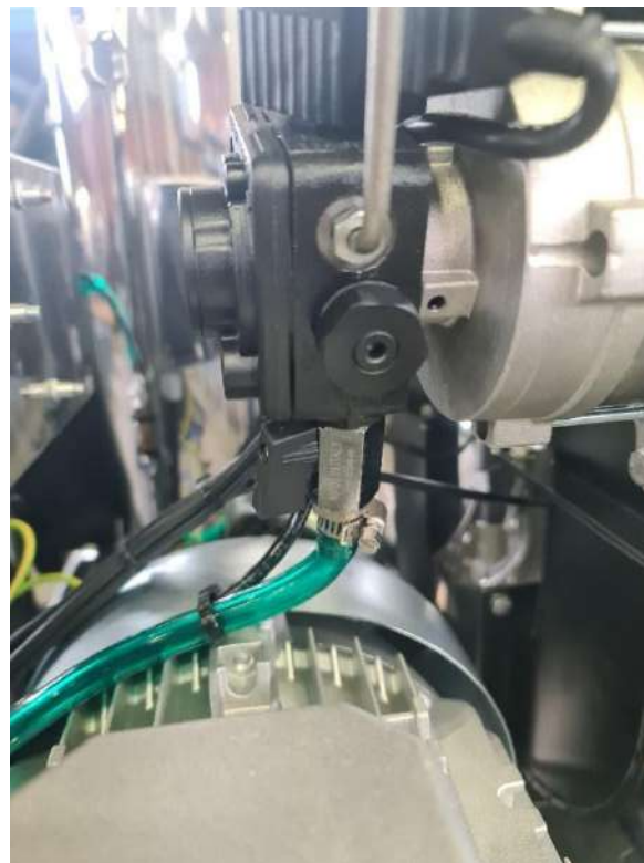
Válvula de bola de seccionamiento de gasóleo
