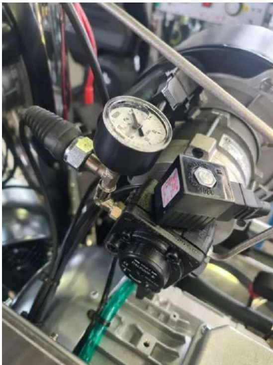
Manómetro de la bomba de gasóleo
